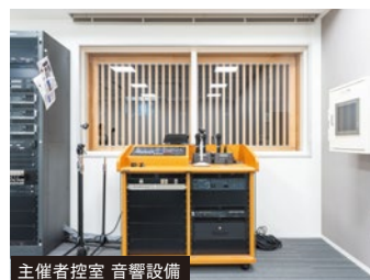
主催者控室 音響設備
